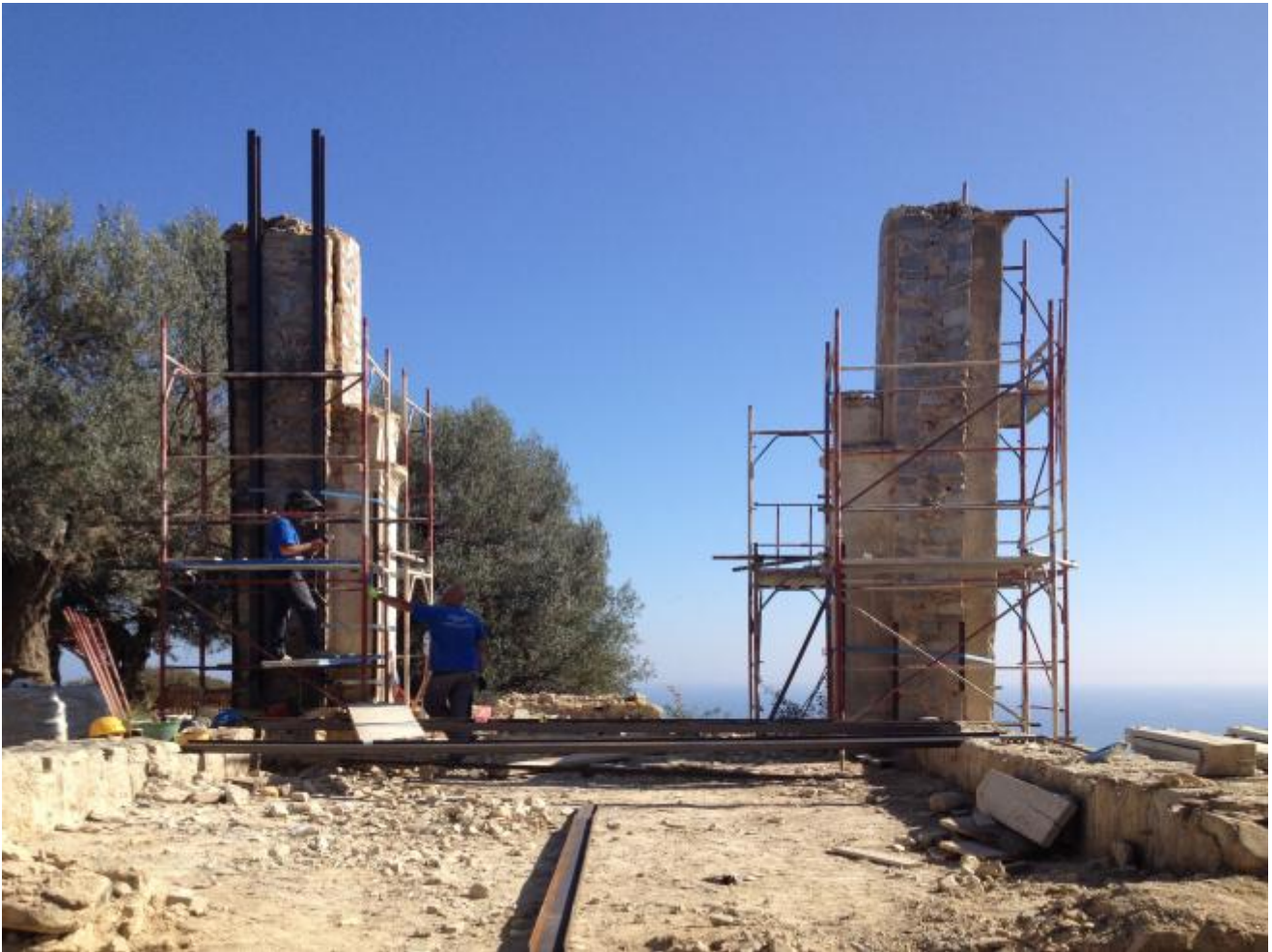
Cappella della Madonna del Carmine di Montegiordano, il cantiere nello stato attuale
